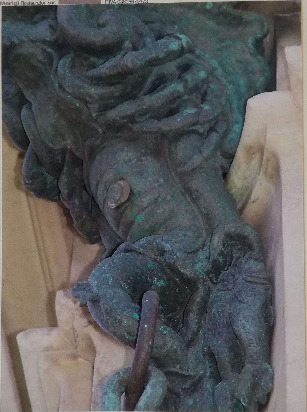
Foto 5. Uno dei Mascheroni con pustole di corrosione attiva.
