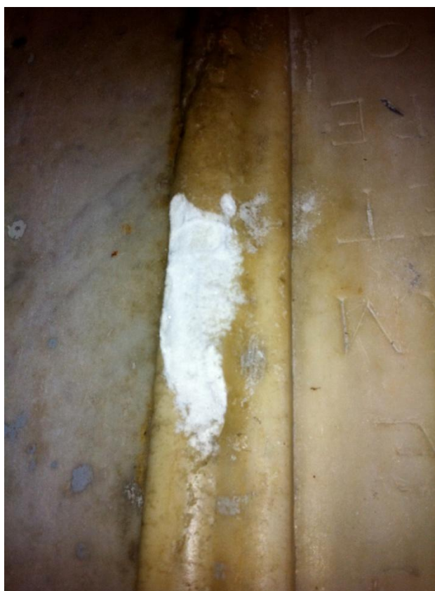
Presenza di efflorescenze saline (stato prima del restauro)
