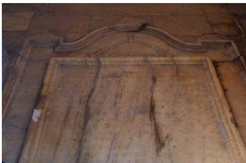
Presenza di depositi, Sali ed alterazione della patina (prima del restauro)
