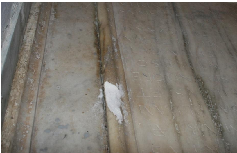
Efflorescenze saline ed alterazione cromatica delle superfici
