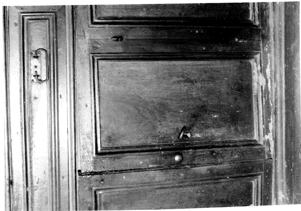
Particolare stato precedente
