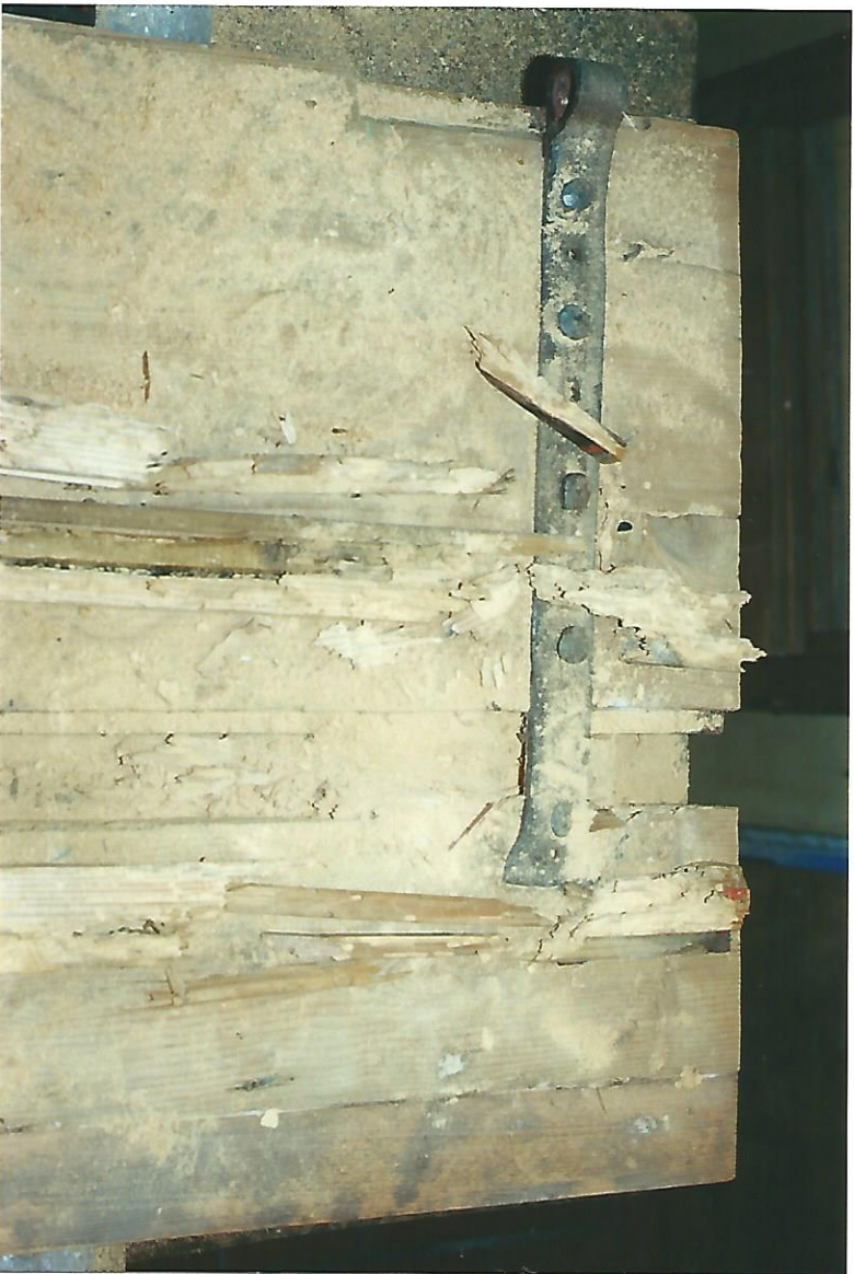
Interno, eliminazione delle parti deteriorate dall' Hyloterpes bajulus , particolare
